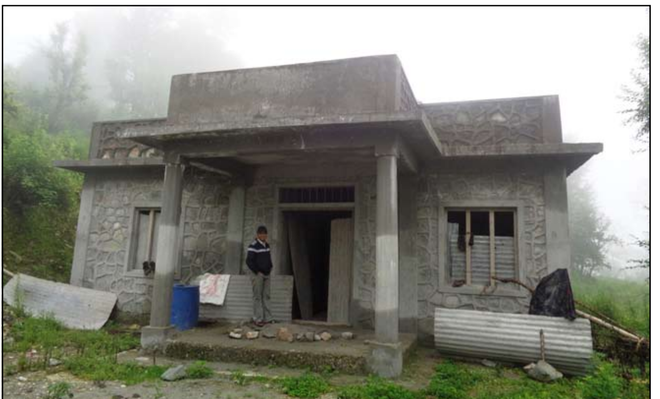
अलपत्र भवन : काम पुरा नगरी ठेकेदार भागेपछि अलपत्र परेको निर्माणाधिन शिख गाविसको कार्यालय भवन । तस्विर नवविकल्प
