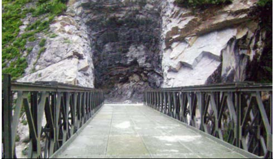
म्याग्दीको नारच्याङ गाविसमा निर्माणाधीन अवस्थामा रहेको मिस्त्रीखोला जलविद्युत आयोजनाको सुरुङ निर्माण स्थल । तस्वीर : ठाकुरप्रसाद आचार्य
